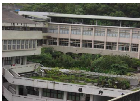
泰山高中 屋頂多重植物栽種，惟經費不足，屋頂無法全部施作，僅提供部分來增加綠化量與美觀，減少頂樓室內熱能消耗。
