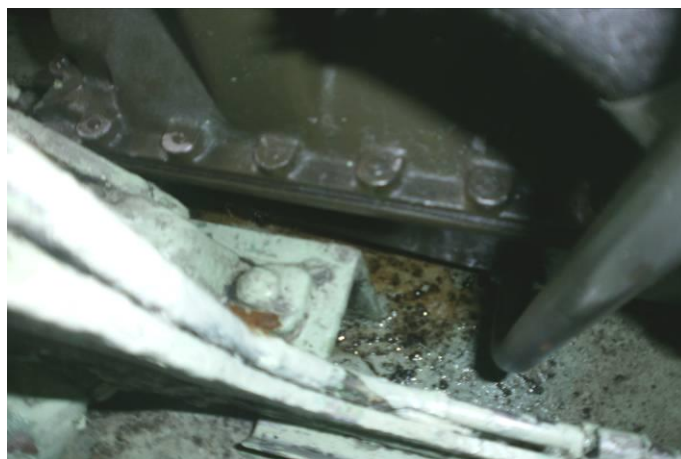
圖四 變速箱機油漏油現況圖
