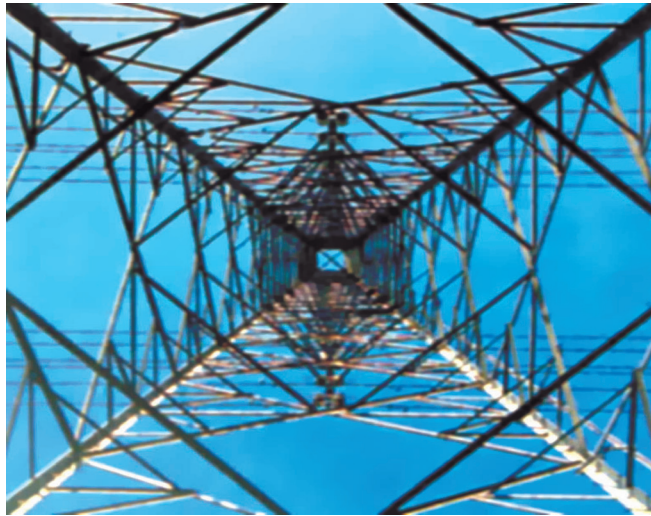
對稱均衡的高壓電塔
