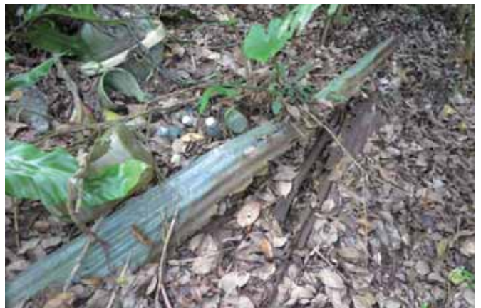
原本用來蓋王丁寮屋頂的鉛片，如今差不多快腐蝕光了。
