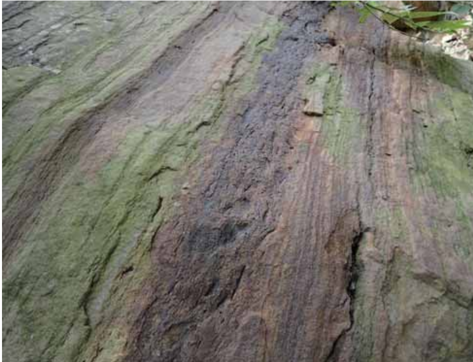
厚砂岩沉積時因不同物質沉積其間，容易形成發達的節理。
