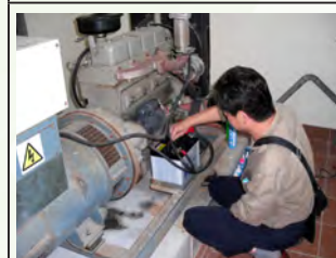
電機設備定期檢查
