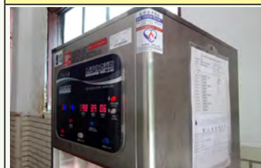
設備定期保修並完整紀錄
