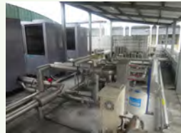
水池熱泵加熱系統
