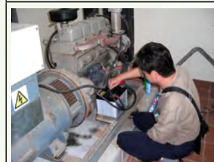
電機設備定期檢查
