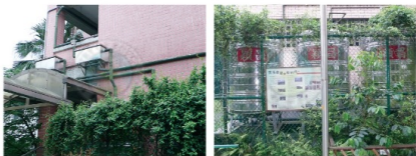
(a)房屋上的收集管線
