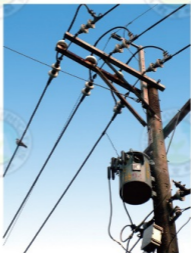
圖11-17 電線桿上的變電桶可以將來自電廠的高壓電轉變成比較安全的「低壓電」，以供家庭使用。
