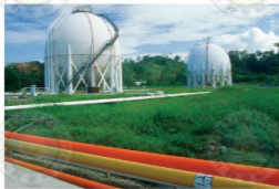
(a) 天然氣瓦斯槽
