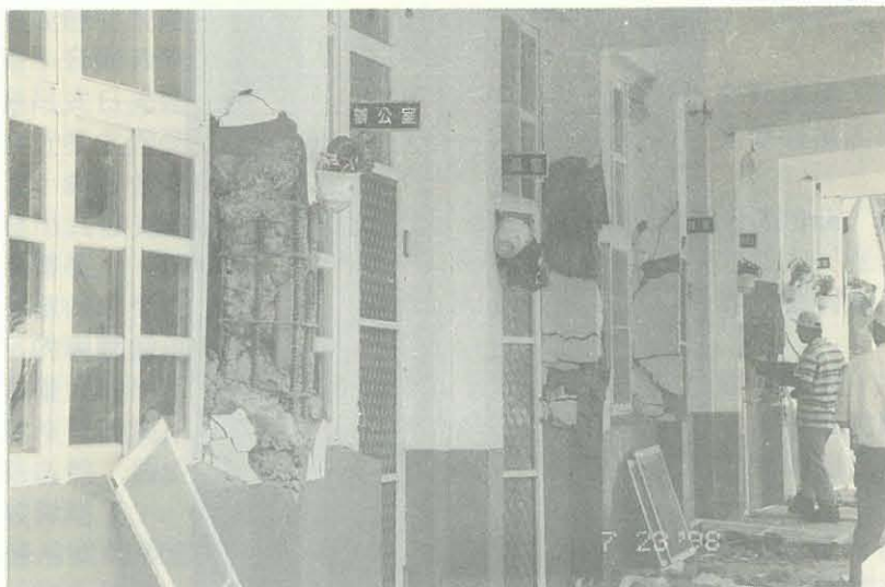
照片6. 培英國小柱子受損窗戶彈落
