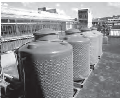
建置雨水再利用系統，以水撲滿儲存雨水。
