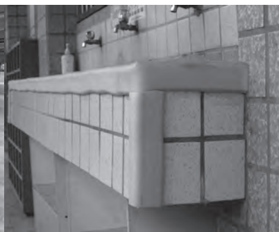
水槽轉角均安裝防撞角
