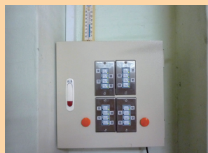
建置電力監控系統
