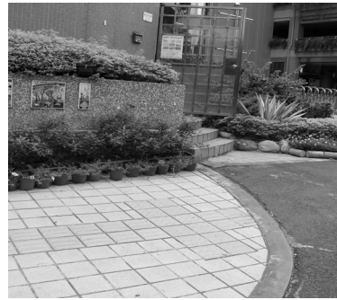
圖 4-2 某國小校門外之引導通道，導盲磚的導引方向出錯
