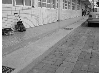
圖 4-4 某國小施工前的引導通道上水溝升高
