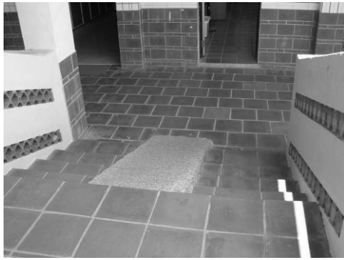
圖 4-11 某國小坡道寬度不足， 造成輪椅行進困難
